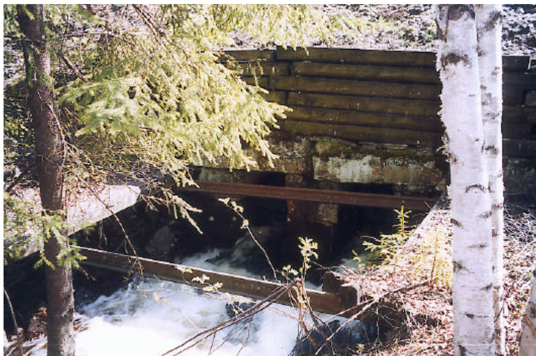
Figur 10.b.9 Mur av tresviller for å hindre nedrasing i stikkrennas utløp
