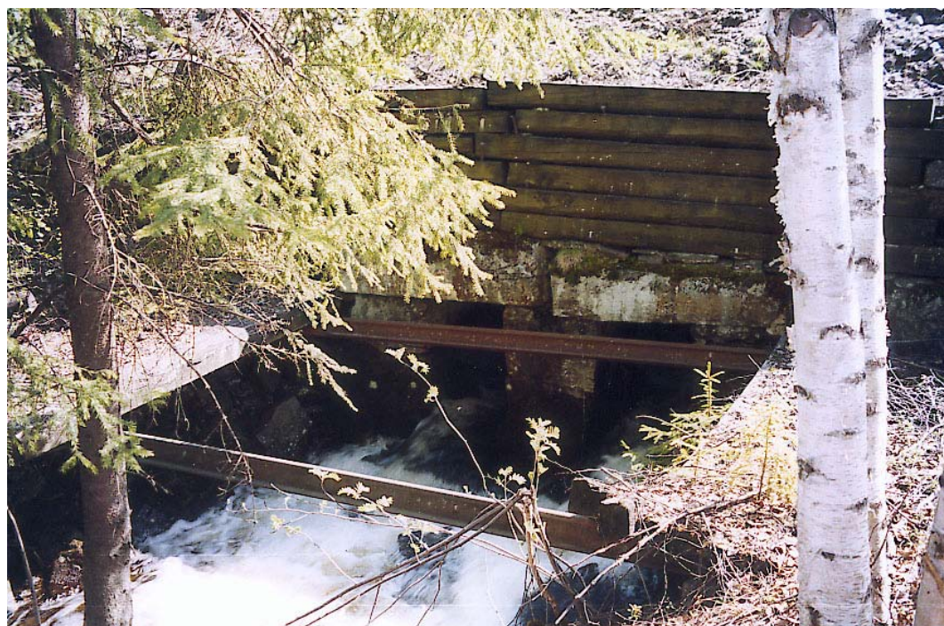
Figur 7.b.9 Mur av tresviller for å hindre nedrasing i stikkrennas utløp
